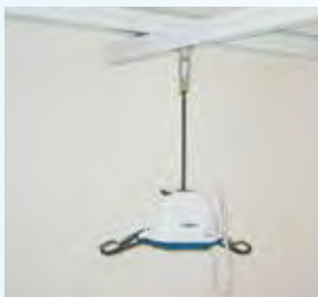
Längs- und Querschienen an Betondecke
